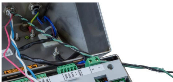
Figura 2-52: Cables de conexión a tierra y alambre de fuga interno torcidos juntos
