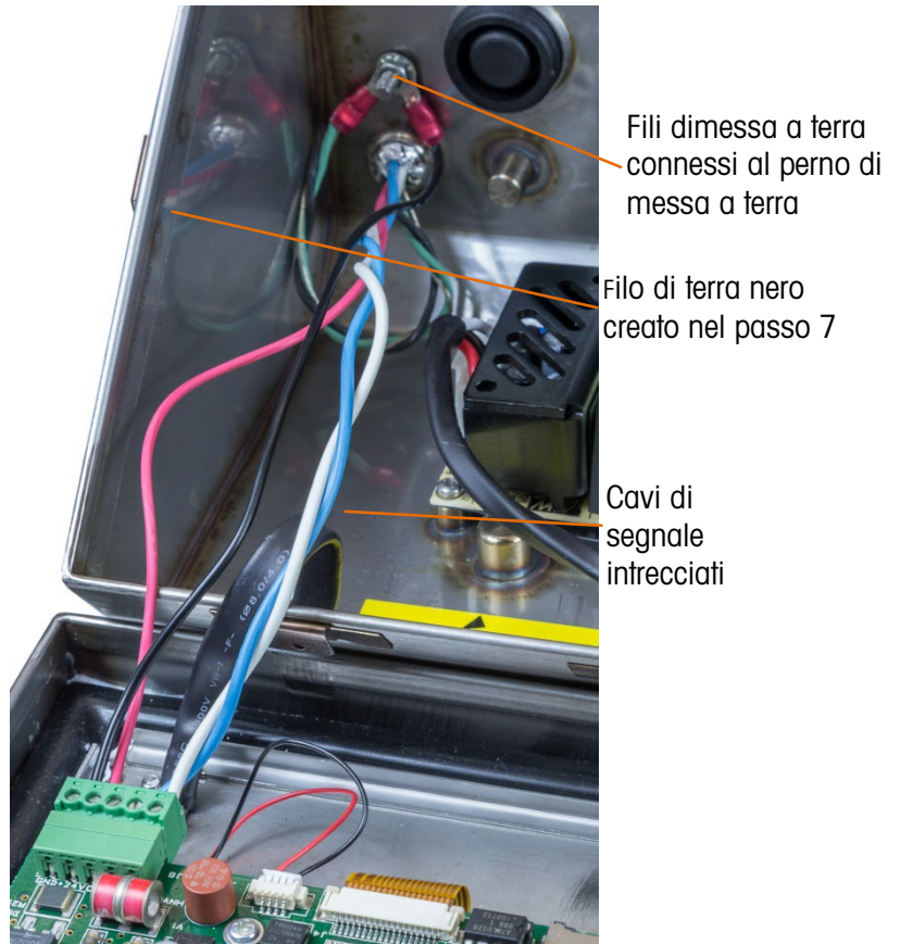
Figura 2-55: cablaggio interno POWERCELL completato
