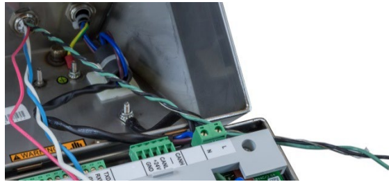
Figure 2-52 : Câbles de mise à la masse et câble de masse interne torsadés ensemble
