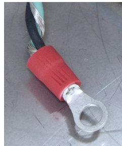
Figure 2-53 : Terminaison du câble de masse
